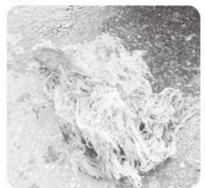
マンホールポンプに詰まっていたモップ
