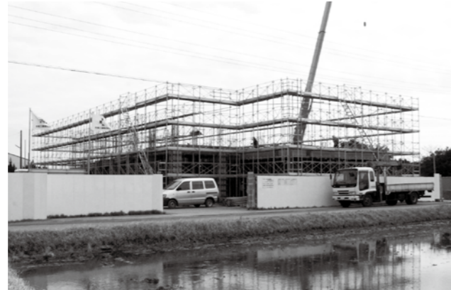
【集会所併用施設建設状況 (H27.3.6)】 基礎工が終わり、足場が組まれ生コン打設に向け鉄筋加工組立や型枠の施工が行われています。
