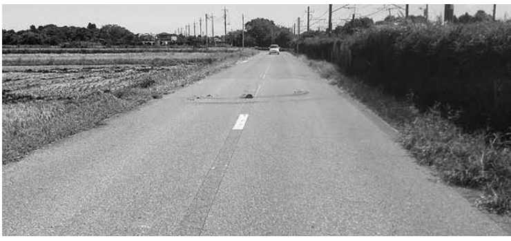
中央線が消えていて歩道がない長生いきいきロード
