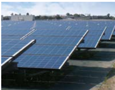
【太陽光パネル】
