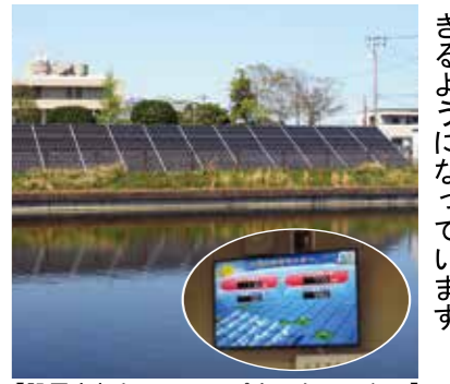
【設置されたソーラーパネルとモニター】
