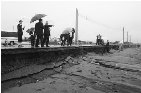
侵食により崩落した駐車場
