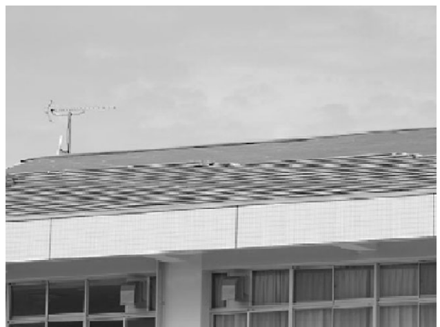
破損した当時の様子
