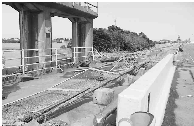
津波被害を受けた南中瀬水門付近
