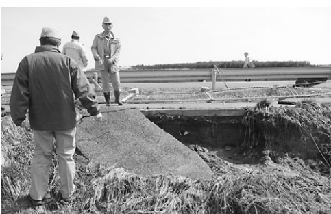
被害を受けた波乗り道路
